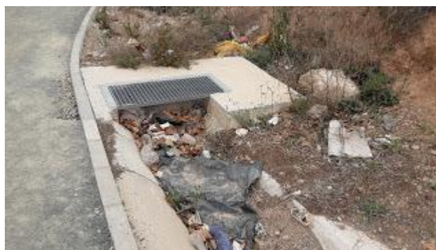
Canales de recogida de aguas totalmente embozados.
